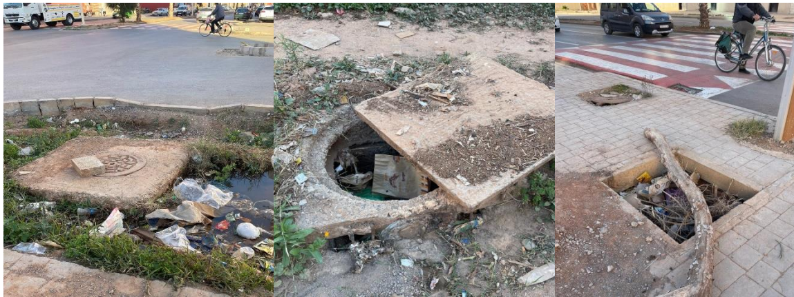
صورة 3: اختناق وضعف الصيانة لشبكة الصرف الصحي بمدينة بركان (تصوير شخصي بتاريخ يناير 2024)
